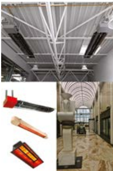
Tubes et panneaux rayonnants
