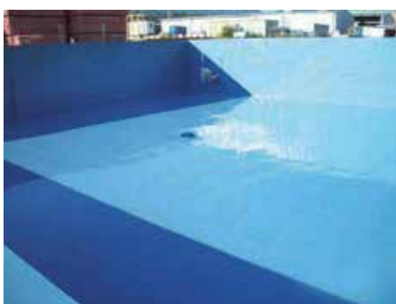
Stratifié époxy plus fibre de verre Bassin de récupération des eaux industrielles avant traitement
