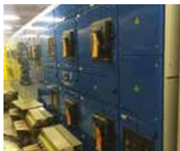
Masterpact 3-4 poles armoire TGBT dijoncteurs 3/4P onduleurs batteries
