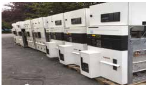
Cellules électrique / marque Granny Abb Schneider Electric Fluokit M24+ ect Poste beton extérieur
